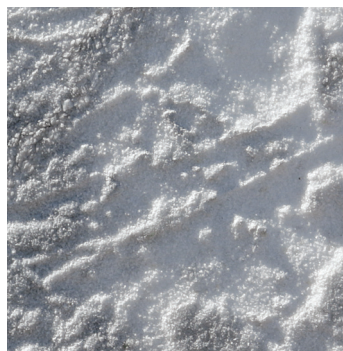
Pérdida de cohesión granular
