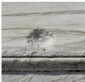
Daño por impacto
